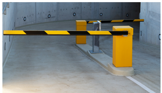
Automatisation des portes
